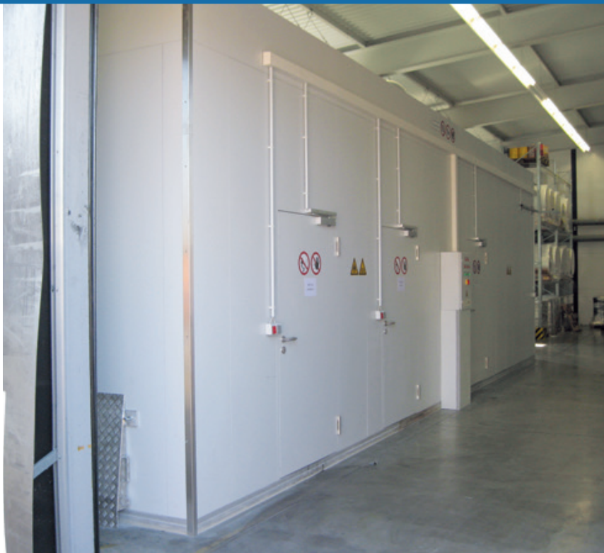
F90-Gefahrstofflager mit 4 Lagerabschnitten
